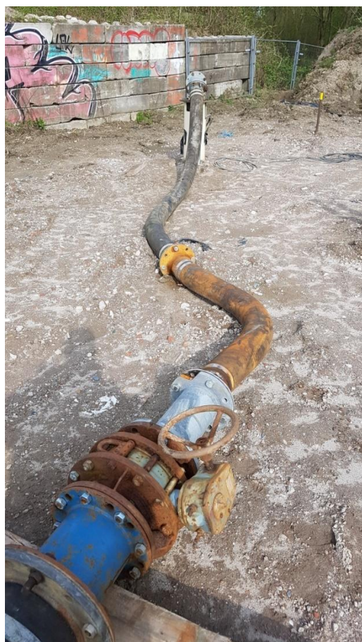
Figuur 12.2 Pompput 2 met afvoerleiding en afsluiter
