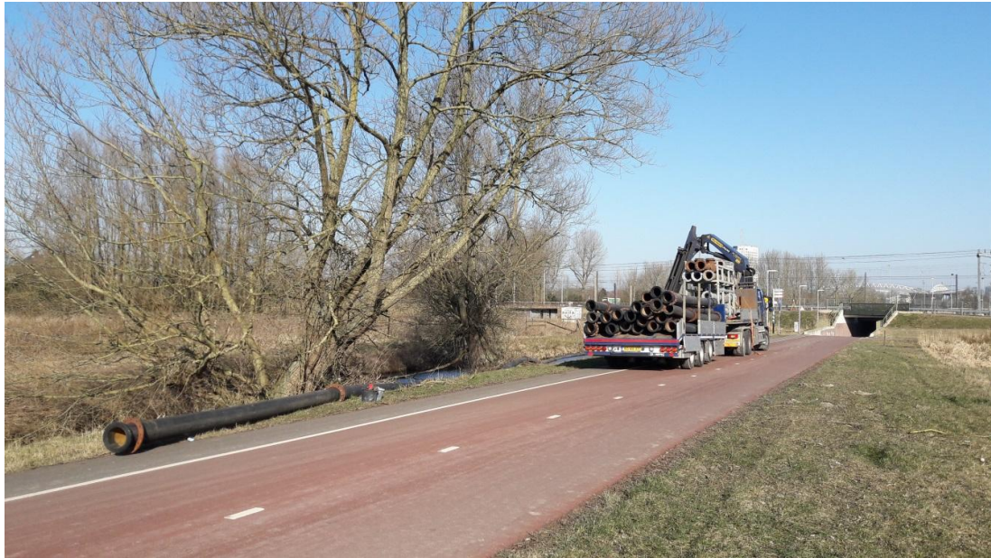
Figuur 12.6 Aanvoer en aanleg van de HDPE-pijpdelen voor de retourleiding langs fietspad en sloot
