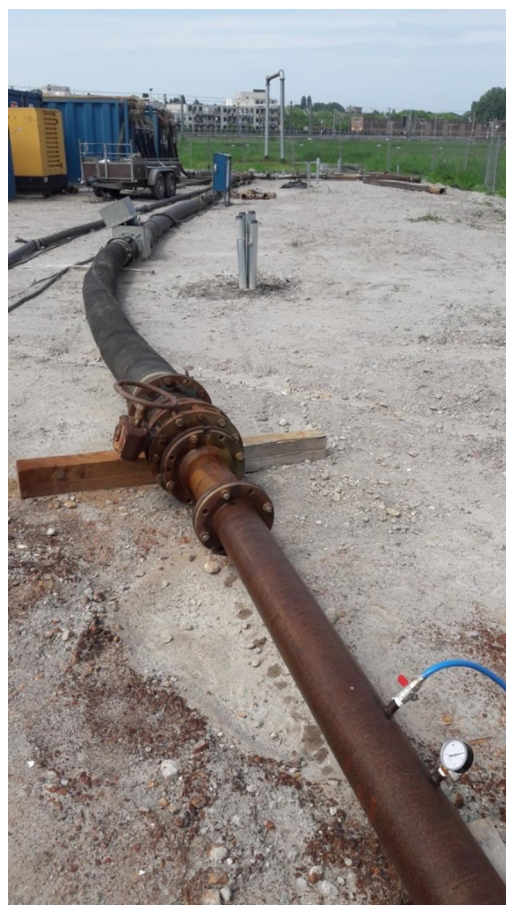
Figuur 12.3 afvoerleiding met manometer, monsternamepunt, afsluiter, watermeter en pijpenbrug over fietspad
