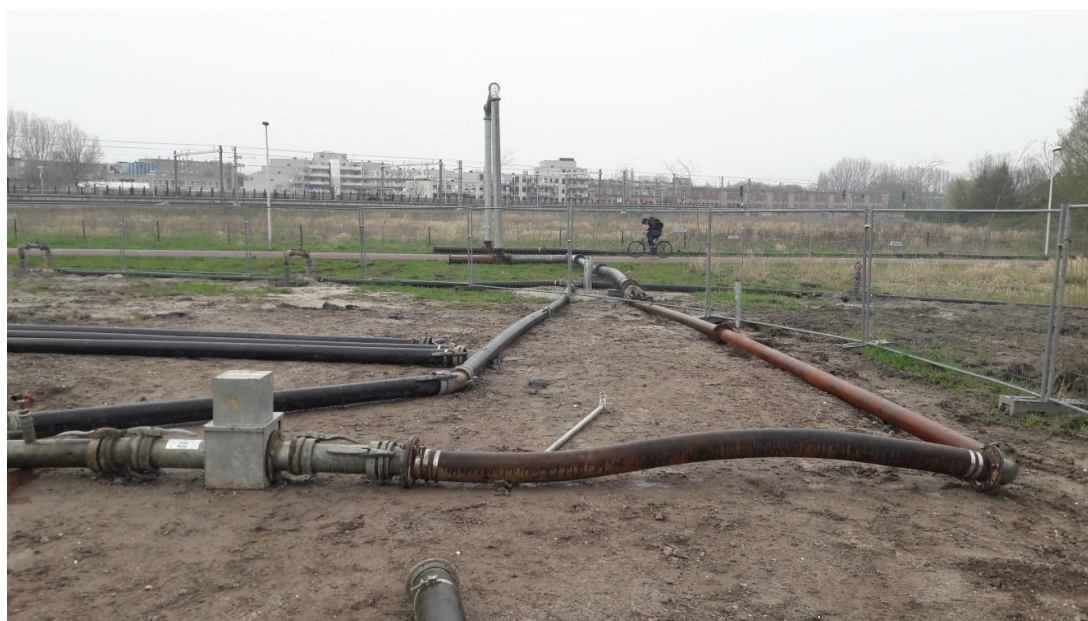
Figuur 12.5 Verdeelstuk naar DSI-systeem 1 achter zuivering en leiding naar retourveld 2, watermeter 2, pijpenbrug
