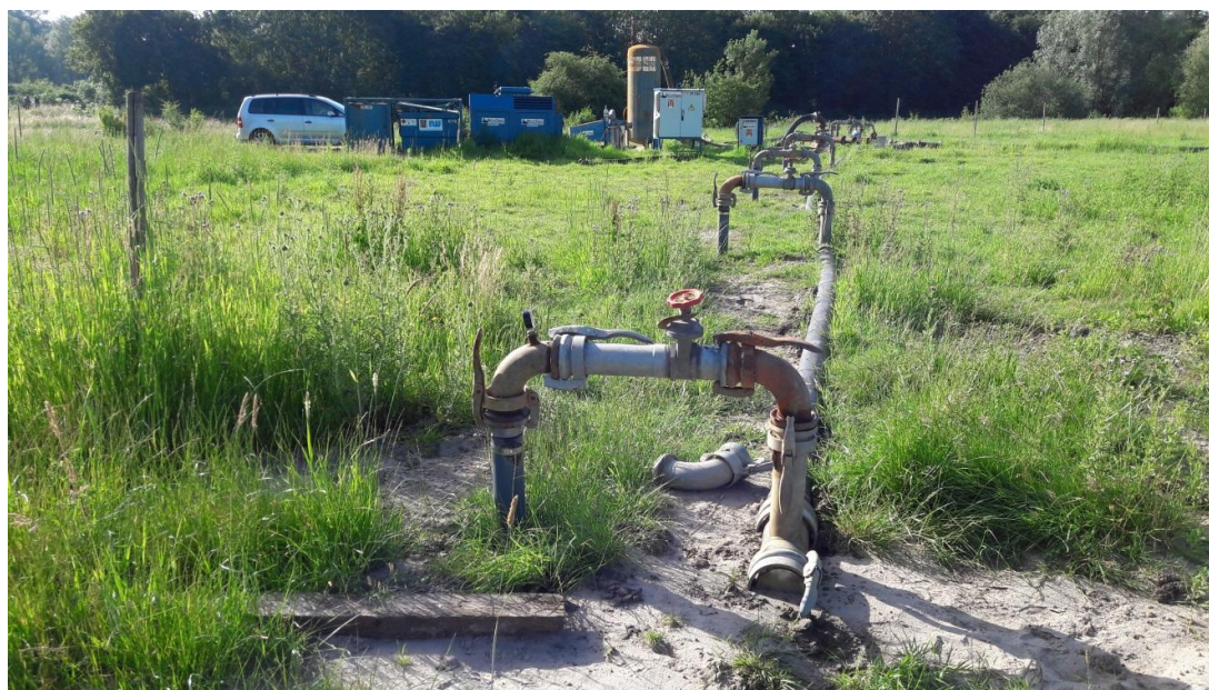
Figuur 12.13 DSI-streng 2 bij in gebruikname, inclusief drukopnemer op de putkop
