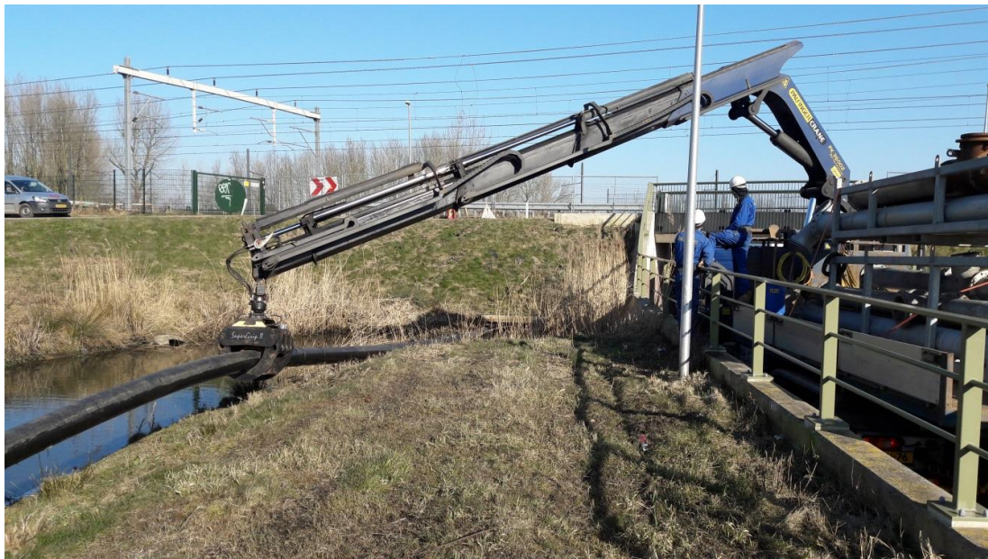
Figuur 12.7 Doorvoer van de retourleiding door de duiker onder de spoorlijn Utrecht - Arnhem
